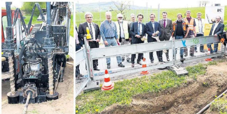
Bis zum Herbst 2014 soll der Ausbau des Breitbandnetzes abgeschlossen sein. Die am Projekt federführend beteiligten Personen informierten gestern in Zotzenbach über den aktuellen Stand der Arbeiten.
